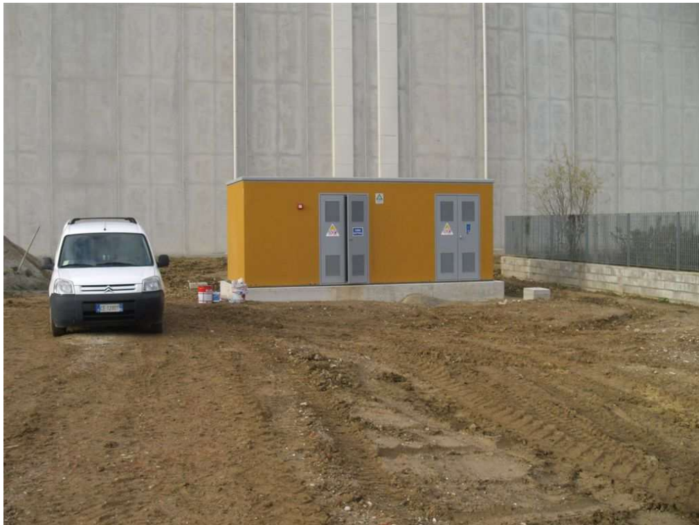
Cabine elettriche per impianti fotovoltaici su fabbricati produttivo in provincia di Verona
